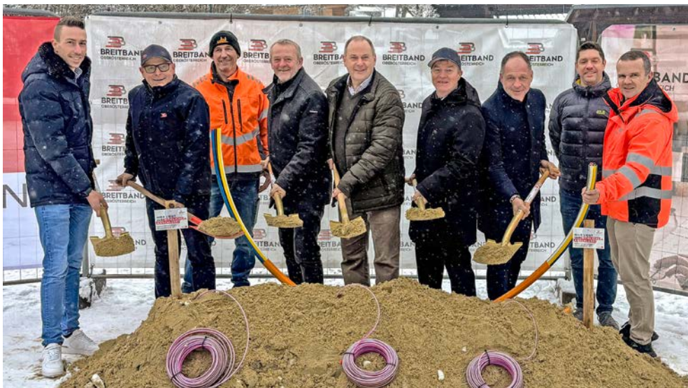
Spatenstich in Oberneukirchen (v.l.): Michael Kovacs (BBOÖ), Martin Wachutka (Techn. GF BBOÖ), Martin Enzenhofer (Bauhofleiter), Walter Limberger (Amtsleiter), Josef Rathgeb (Bürgermeister), Thomas Matthey (Kfm. GF BBOÖ), Manuel Dietinger und Klaus Schremmer (beide Ploier+-Hörmann), Volker Dobringer (BBOÖ)
